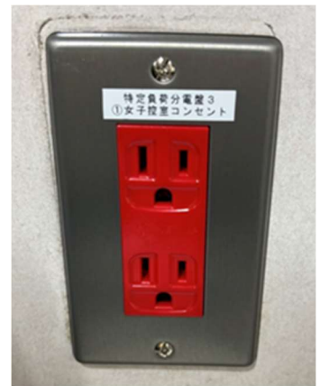
【非常用コンセント】
